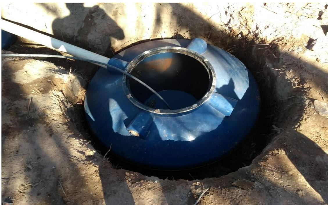
Figura 10 – Presença de raízes e corte no solo com medidas irregulares.
