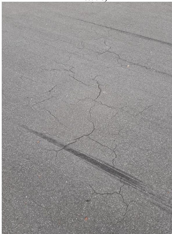
Fotografia 13 – Trinca tipo couro de jacaré (Cabeceira 25 – Amostra 3)
