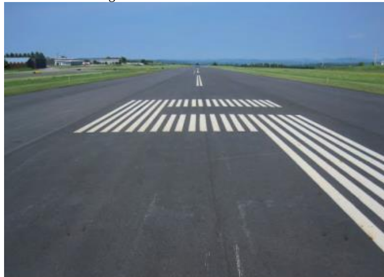
Figura 11 – Pavimento com PCI 100
