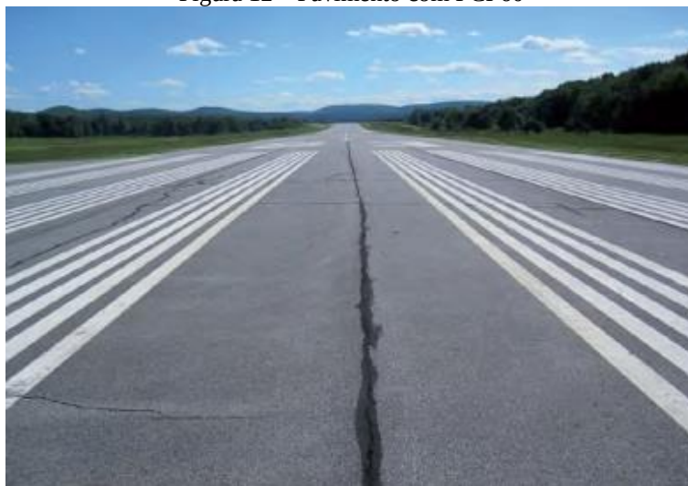
Figura 12 – Pavimento com PCI 60
