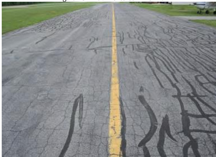
Figura 13 – Pavimento com PCI 20
