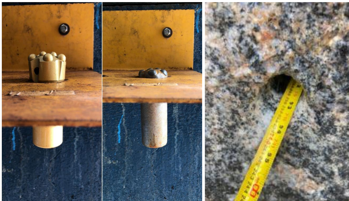
Figura 31 - Falhas na perfuração para a instalação do tirante.
