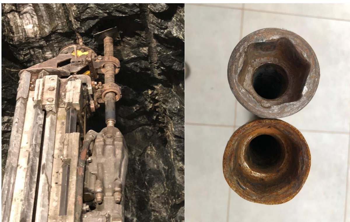
Figura 33 - Falha no acoplamento do batedor no tirante.
