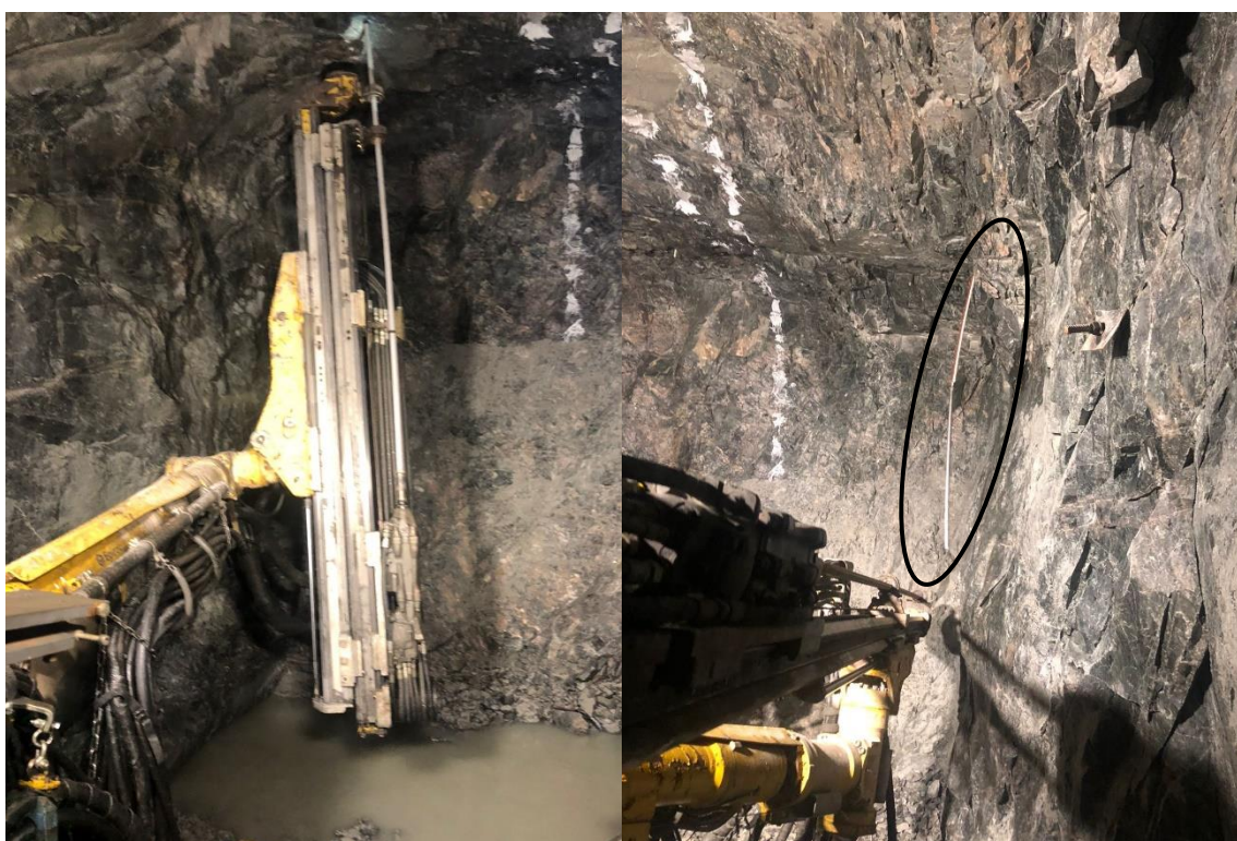
Figura 32 - Falhas operacionais na fase de resinamento.
