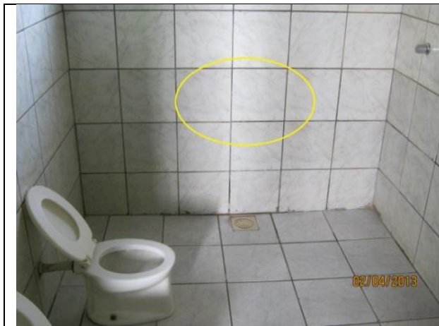
Foto 32 - Fissura no azulejo
