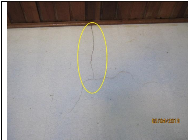
Foto 29 - Fissura vertical e horizontal
