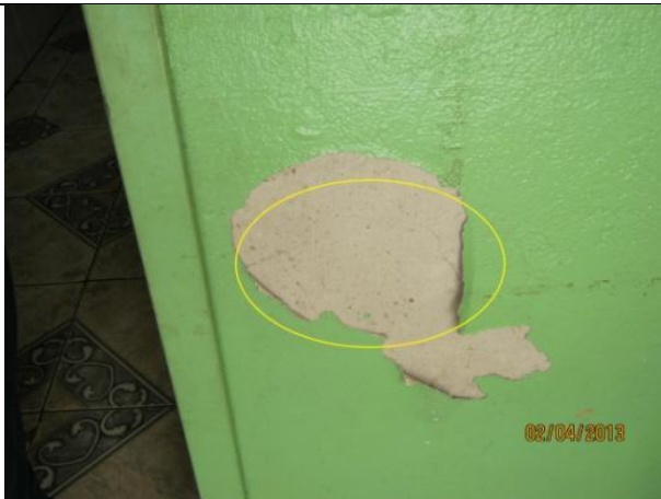
Foto 39 - Descolamento da pintura
