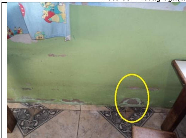
Foto 33 - Desagregação da pintura e do reboco
