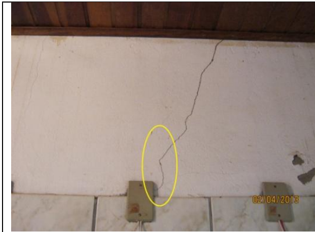
Foto 26 - Trinca vertical na alvenaria
