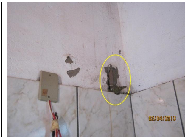
Foto 45 - Vazamento na rede hidráulica
