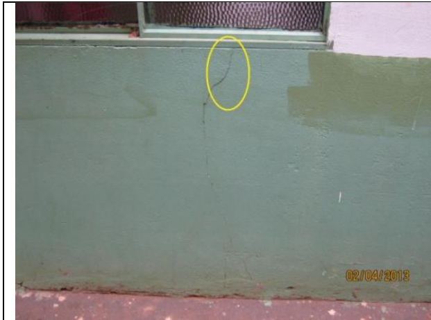
Foto 25 - Trinca vertical em alvenaria sob de janela
