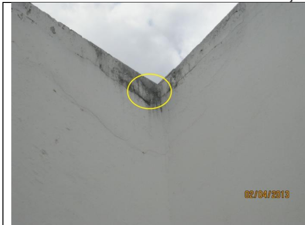
Foto 31 - Presença de fungos no reboco
