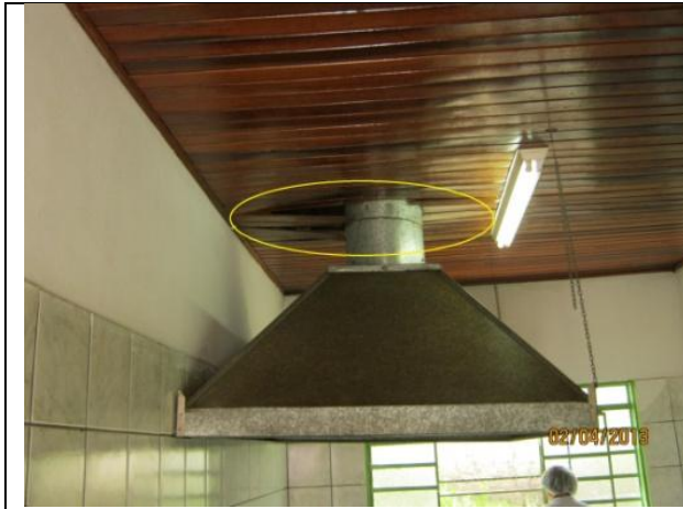
Foto 34 - Descolamento vertical do forro
