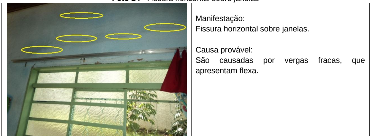
Foto 24 - Fissura horizontal sobre janelas
