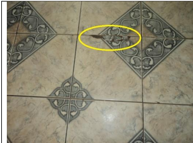
Foto 35 - Piso cerâmico com trincas
