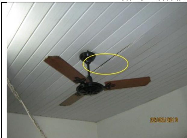
Foto 13 - Descolamento vertical do forro
