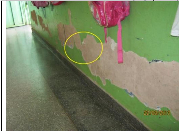
Foto 11 - Desagregação da pintura e do reboco na parede
