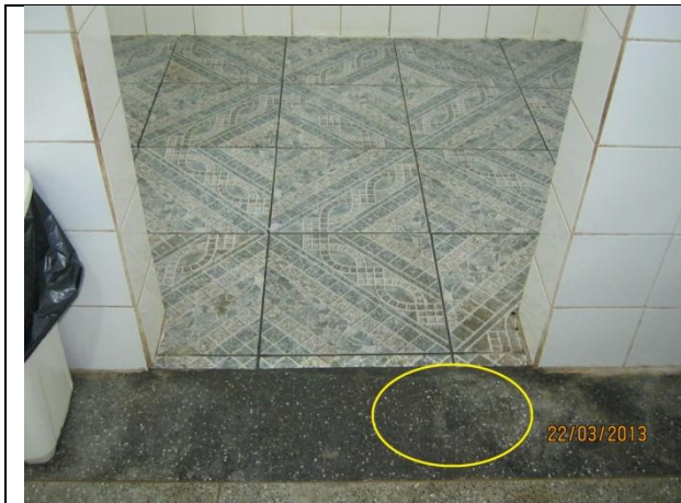
Foto 12 - Manchas no piso de concreto polido
