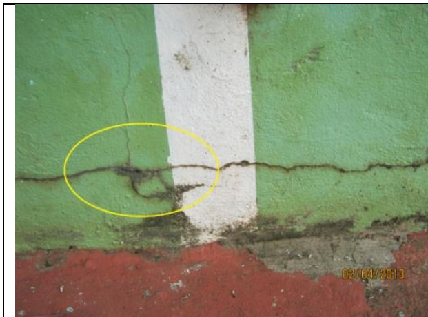
Foto 27 - Trinca horizontal na base da alvenaria, acompanhada de fungo
