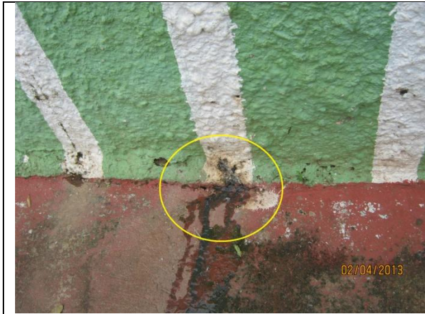
Foto 46 - Vazamento na rede de esgoto
