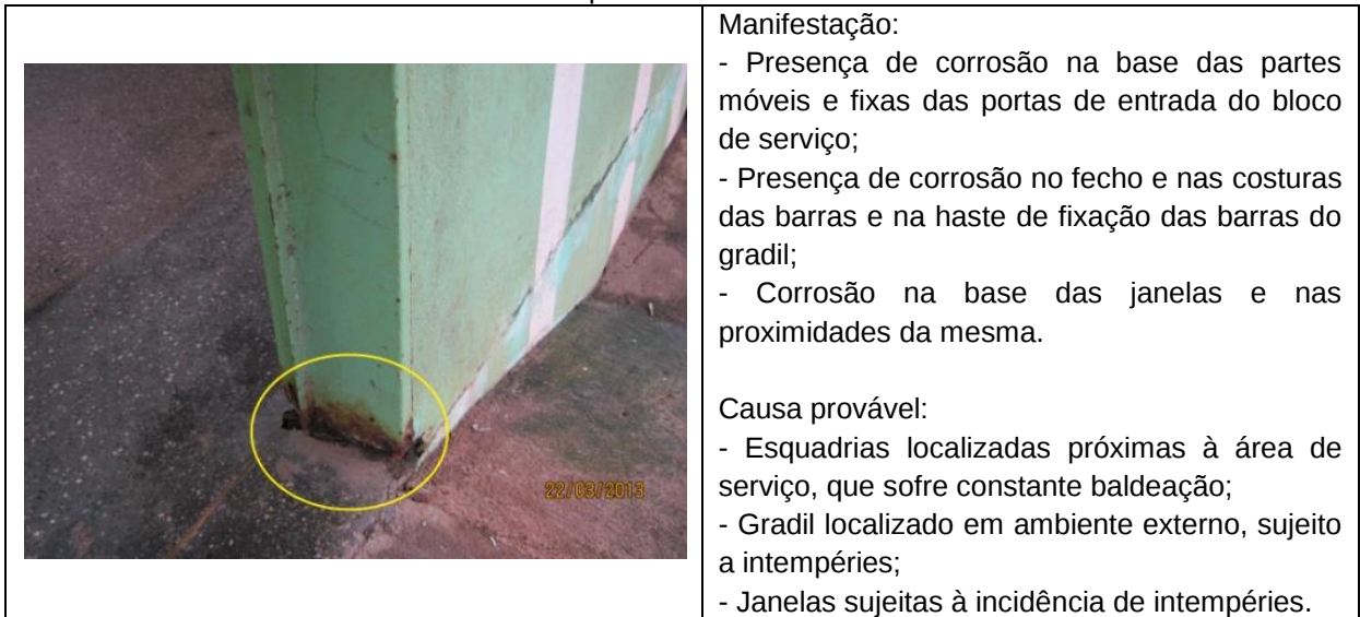
Foto 15 - Esquadrias metálicas oxidadas
