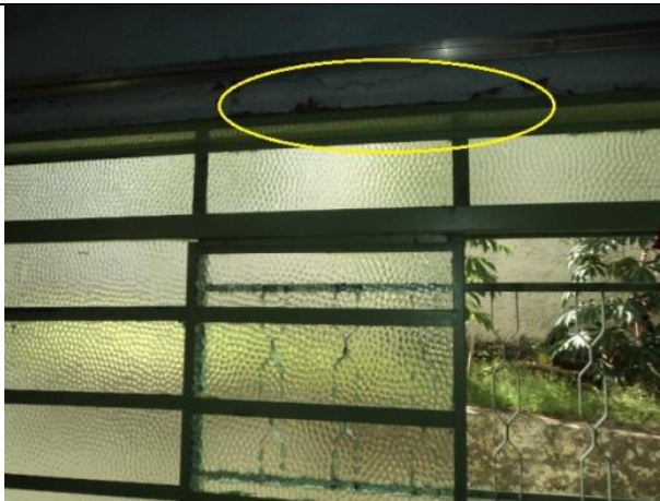
Foto 38 - Fissura horizontal na ligação da janela com a alvenaria
