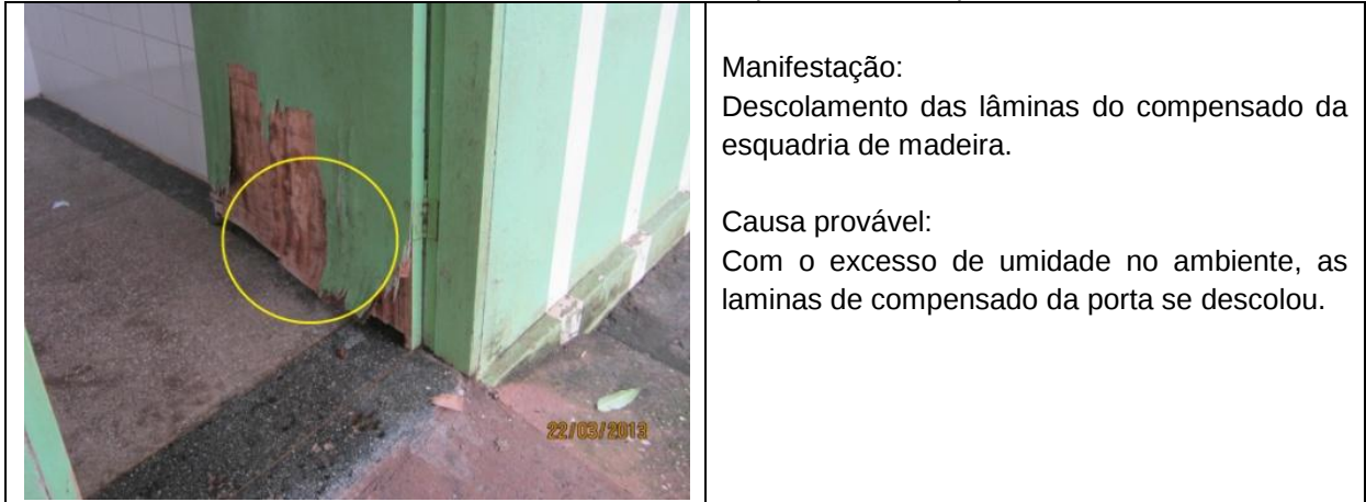
Foto 14 - Descolamento das lâminas do compensado da esquadria de madeira
