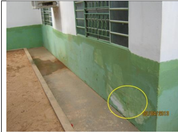
Foto 40 - Manchas na parede por repintura
