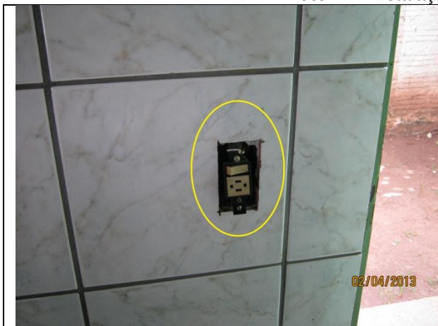
Foto 44 - Instalação elétrica exposta
