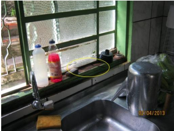
Foto 37 - Corrosão nas esquadrias metálicas
