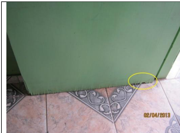
Foto 36 - Descolamento das lâminas do compensado da esquadria de madeira
