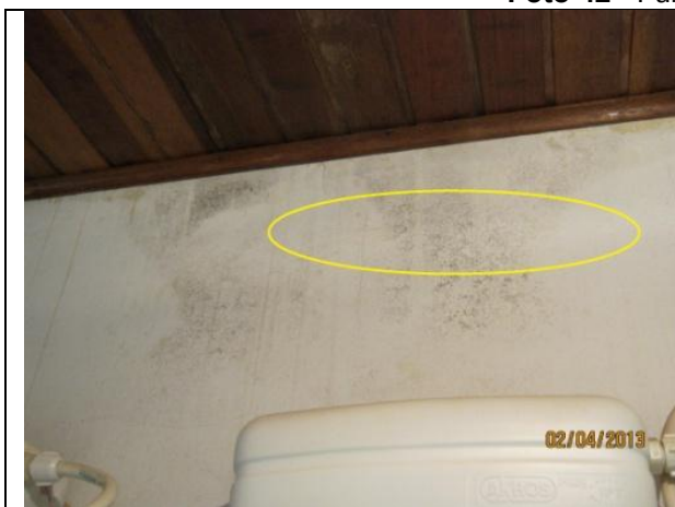
Foto 42 - Fungo na pintura
