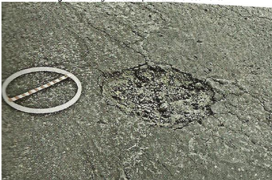
Figura 9 - Surgimento de panela no revestimento
