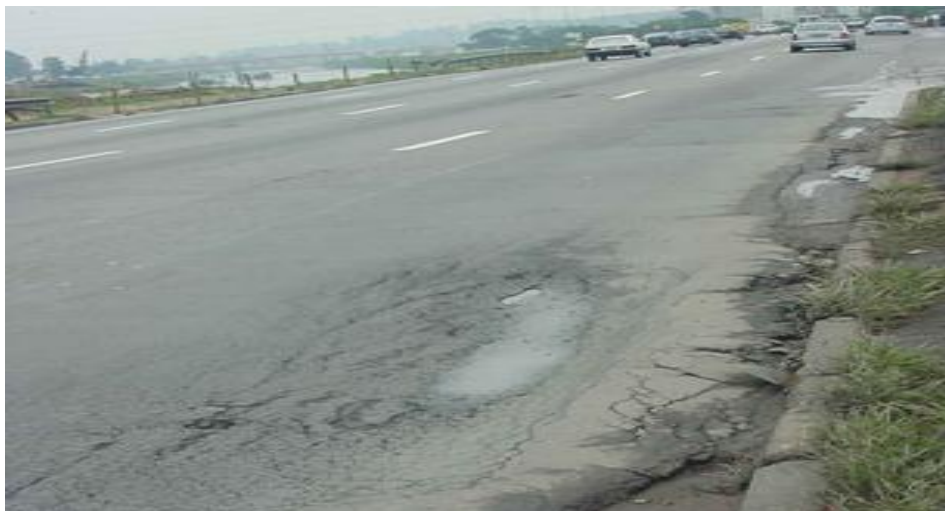
Figura 5 - Afundamento por consolidação
